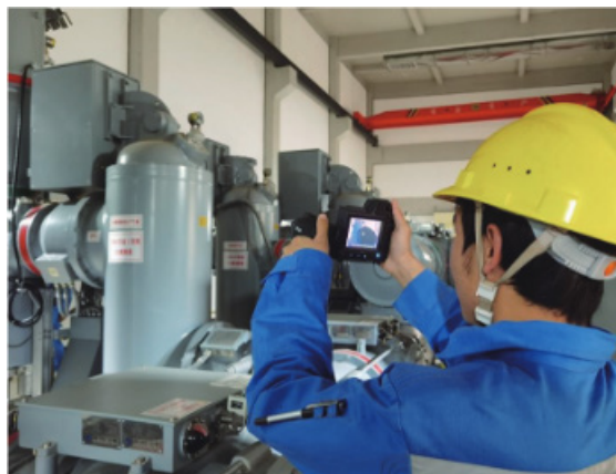
图1 变电站巡检中红外测温图
