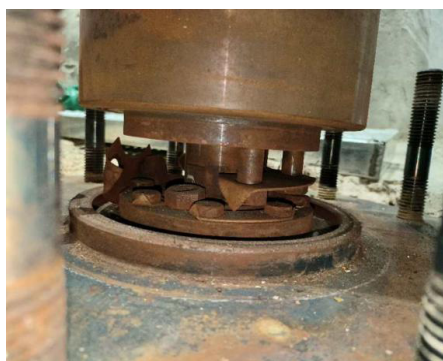
图3 螺栓断裂情况
