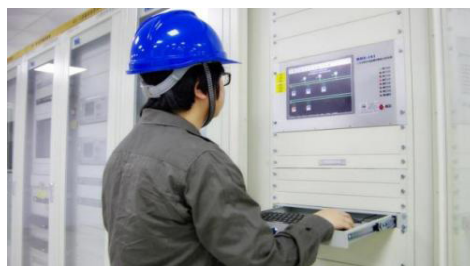
图1 在线监测的智能变电站
