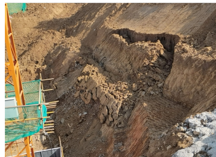
图 2 泵房基坑滑坡示意图
