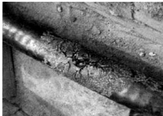
图 2 电缆故障照片
