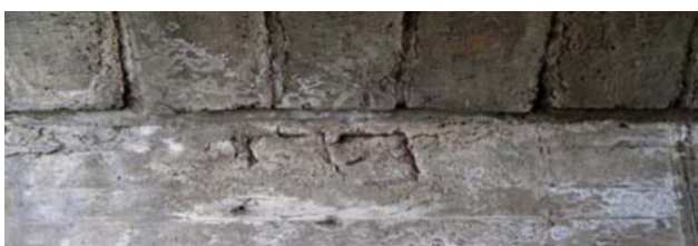
图 2 墩帽梁混凝土表面缺陷
