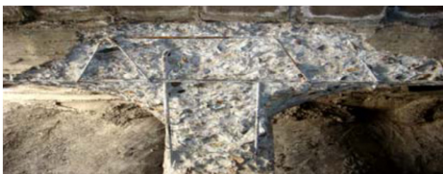
图 1 桥墩和墩帽混凝土脱落
