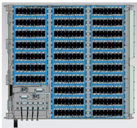
图2 动车储能柜内部
