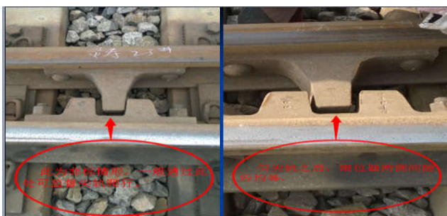
图9 限位器两侧间隙应均等为7.5mm
