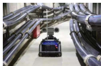
图3 电缆隧道巡检机器人
