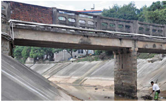
图1 老化的水利工程设施
