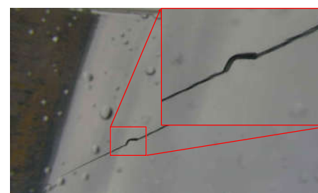
(e) 地线接续管变形
