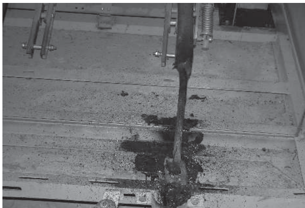
图1 110kV某变电站电缆终端事故现场
