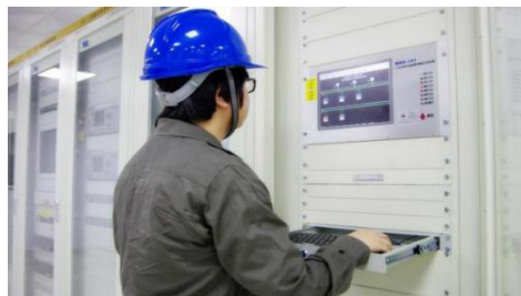
图 1 在线监测的智能变电站
