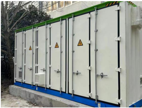
图3 储能系统全貌图
