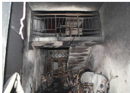
图4 楼梯间1层过火情况
