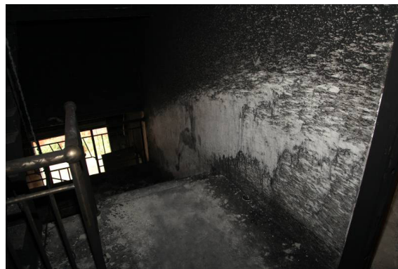
图5 楼梯间2层烟熏情况
