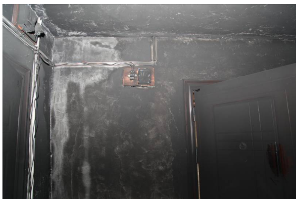
图6 楼梯间3层烟熏情况
