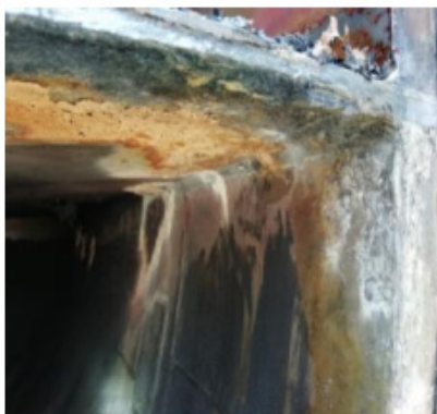
图1 E-0102管箱隔板腐蚀图
