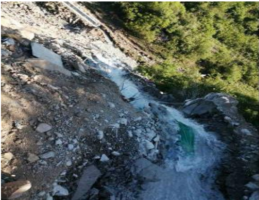
图1 道路边坡随意弃渣
