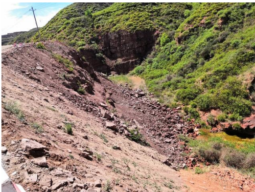
图2 隧道施工废水直接外排
