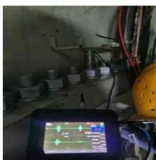
图 2 现场测量某颗螺栓轴力值低
