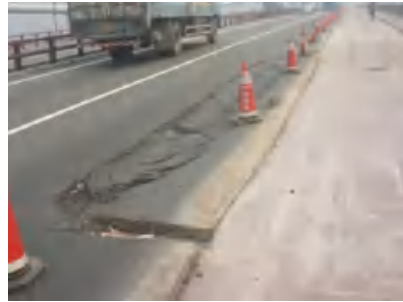
图 2 全桥面铺装层损坏图
