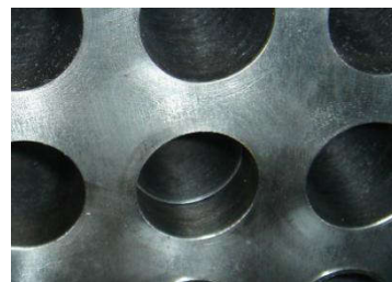
图4 管孔内壁沟槽
