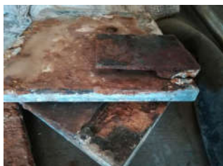
图1 电机底座腐蚀开裂
