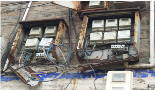
图1 老旧社区电气配线裸露、线路老化”
