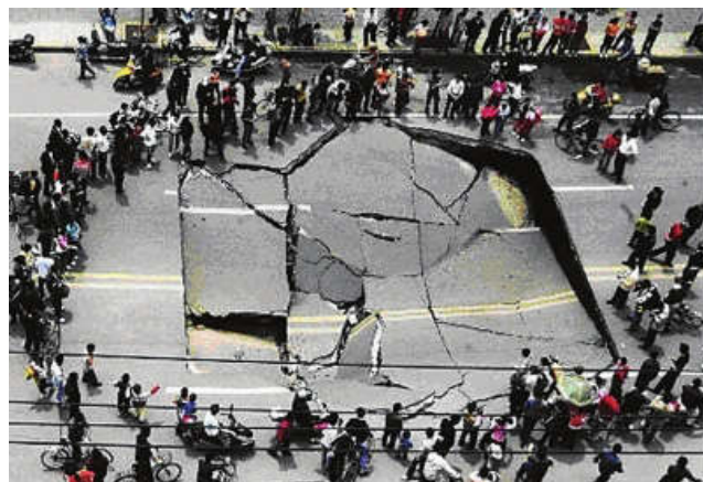
图3 城市道路地面塌陷
