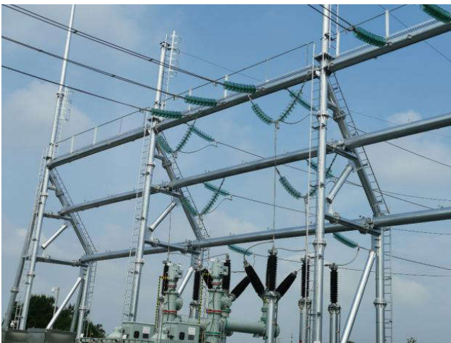
图 9 110kV 联合风帆构架实照
