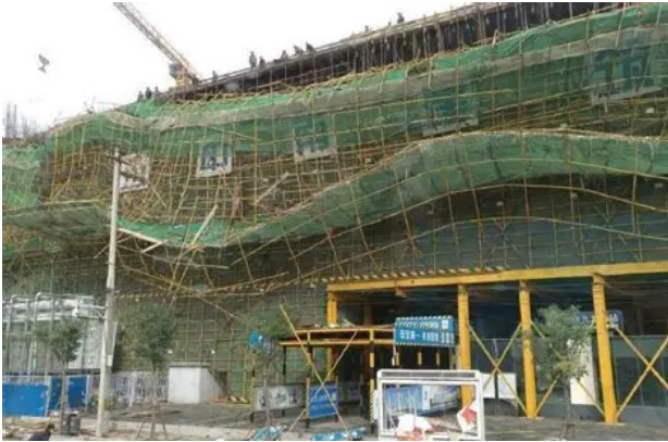
图2 脚手架局部失稳坍塌图
