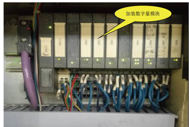
图 1 安装在子站箱内数字量输入模块
