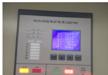
图 2 0kV 进线柜微机保护屏
