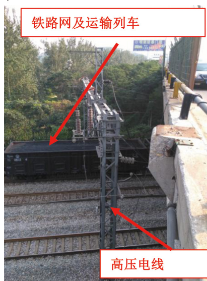
图3 铁路路段高压电线
