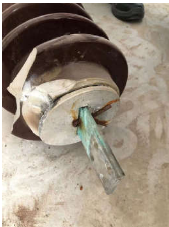
图 2 穿墙套管击穿情况
