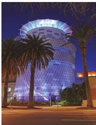
图 2 某数据中心开式蓄冷罐外观图
