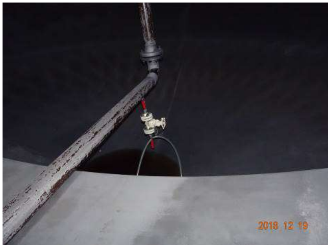
图4 钝化后罐内效果照片
