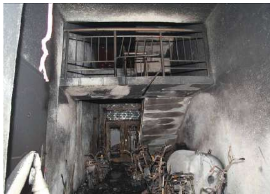
图4 楼梯间1层过火情况
