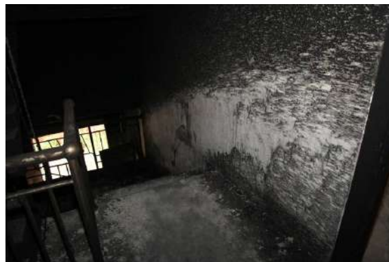
图5 楼梯间2层烟熏情况
