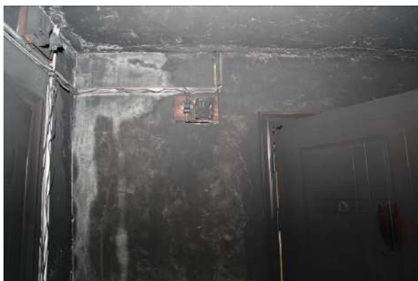
图6 楼梯间3层烟熏情况
