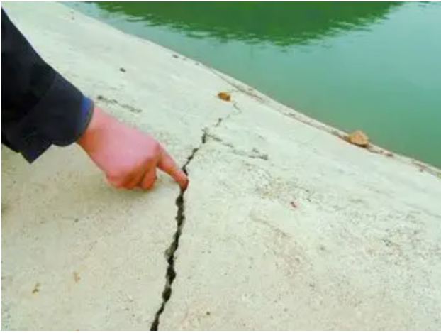
图2 某水库坝体发生的裂缝问题
