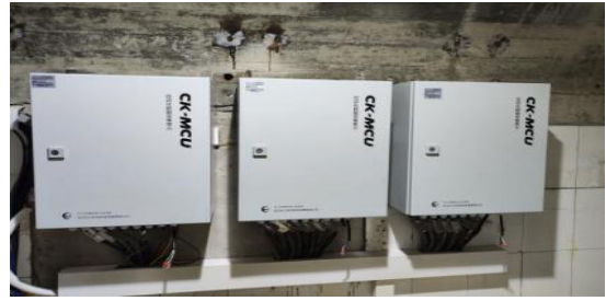
图2 自动化数据采集装置现场安装图
