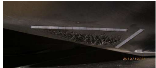
图1 2012年12月戈枕2号机组2#桨叶气蚀情况
