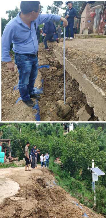
图1 图2 2022年7月31日现场实地复核滑坡变形情况
